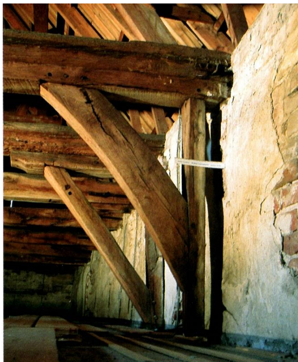
8 De verticale staanders van de sleutelstukken zijn losgeraakt van de muur
